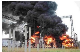
Аварии на критических объектах
